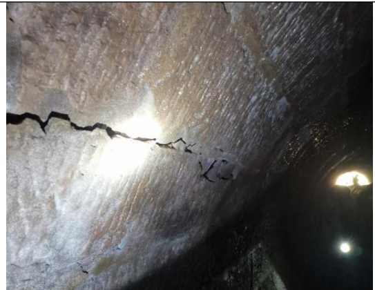
放空洞条石衬砌风化严重段
