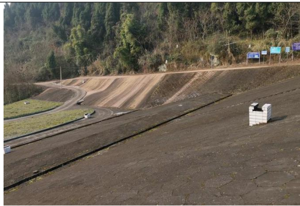
主坝右坝肩渗漏
