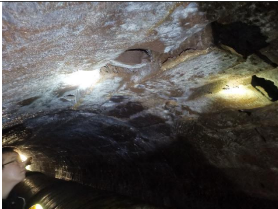
放空洞条石衬砌风化严重段
